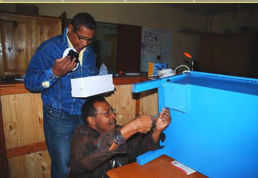
Akumontage und Stromleiste
