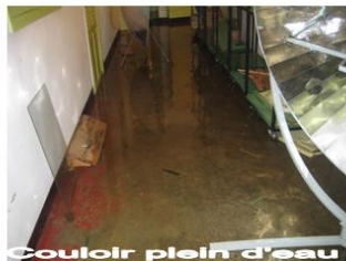
Couloir plein d'eau
